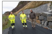
Fylkesveier underveis på Kvamsøysa. Her er trossen på øya, alle Røstebund fast. FOTO: INDER VIKEN
