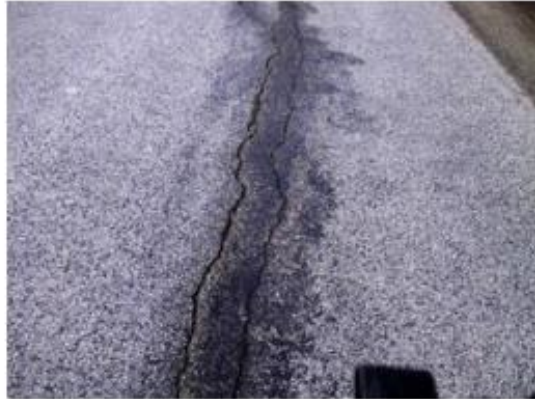
Langsgående sprekker Longitudal cracking
