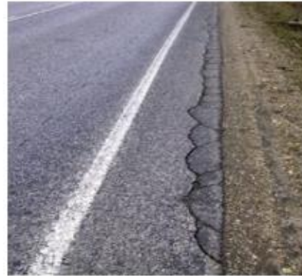
Kantsprekker Edge defect
