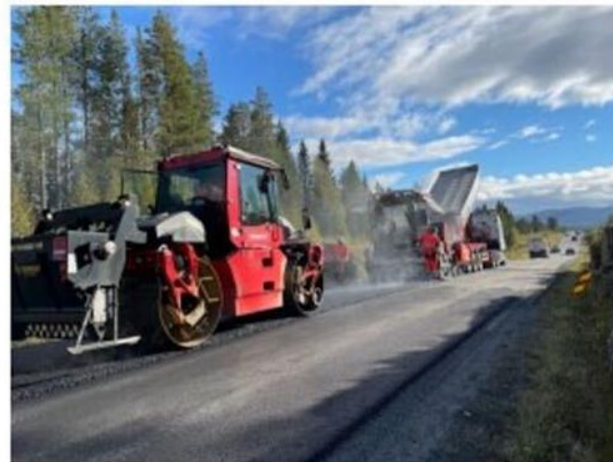
Illustrasjonsbilde. Asfaltering av E14 i Trondheim. Uttesting av biogent bindemiddel høsten 2021. Foto: Ellisor Marsen
