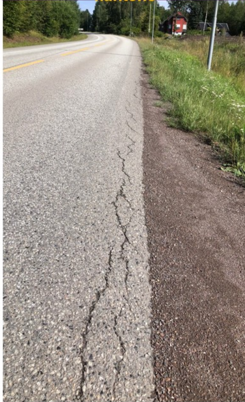
Sprekker i midten - og i kantene
