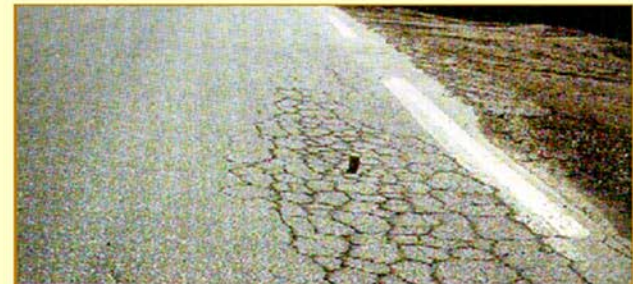
Krakeleringer i dekket
