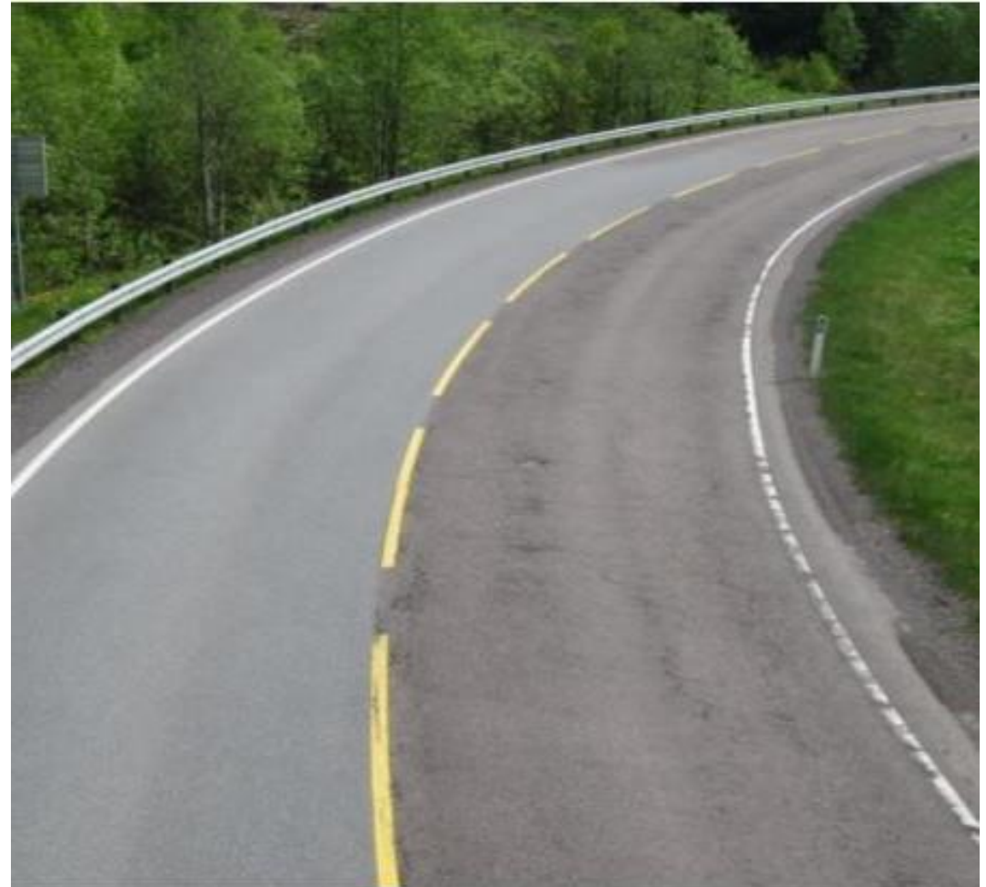
Eksempel på asfaltdekker med god og dårlig bestandighet. Begge dekkene ble lagt samtidig. Fra sluttrapporten for Varige vegger. (Foto: Rune Lien)
