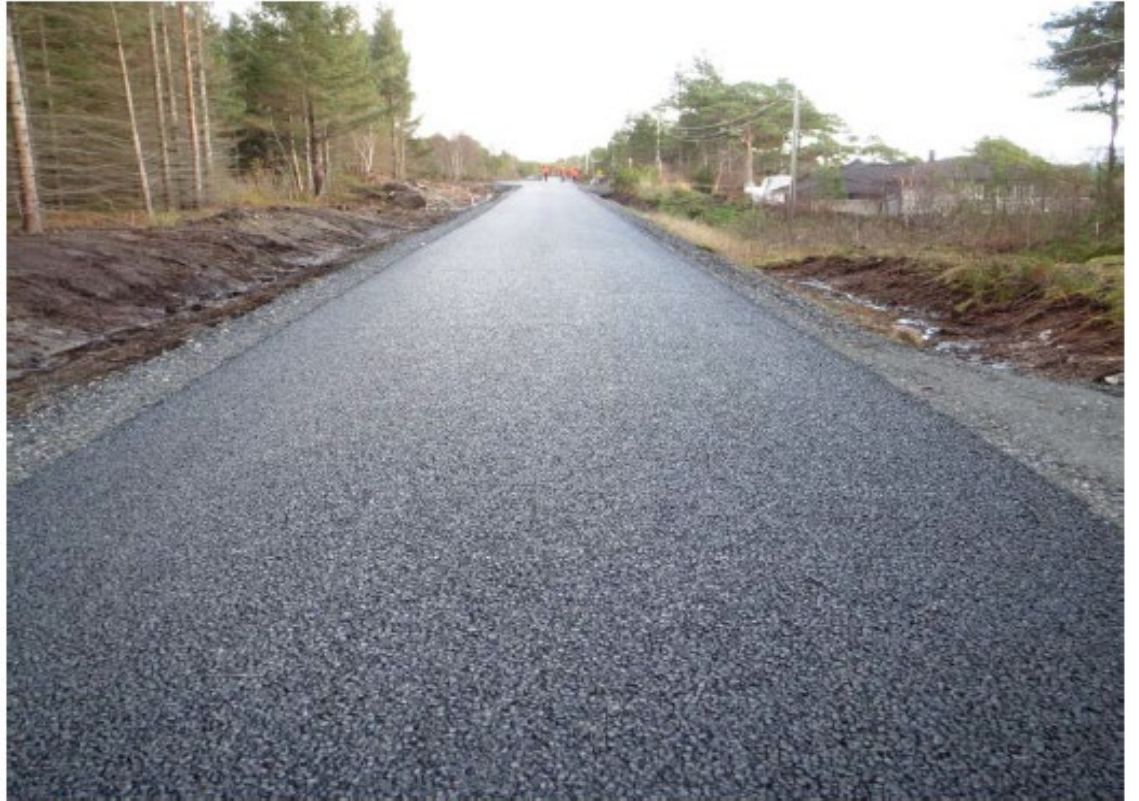
God utførelse, homogent asfaltdekke (foto: Jan Sundstrøm)
