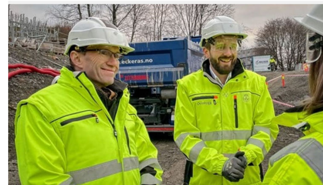
Klima- og miljøminister Espen Barth-Eide og næringsminister Jan Christian Vestre besøker nye Tøyenbadet som er under oppføring i Oslo. Foto: Klima- og miljødepartementet
