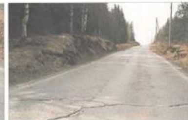
Sprekk, alvorlighetsgrad H
