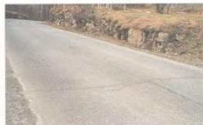
Sprekk, alvorlighetsgrad M
