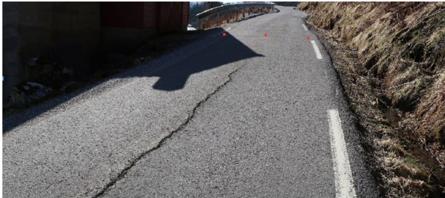
Nærmest viser telesprekker på delstrekket som kun ble nyasfaltert. Dypstabiliseringen startet ved markerte røde punkter. Foto: Rune Kilen Lindås kommune
