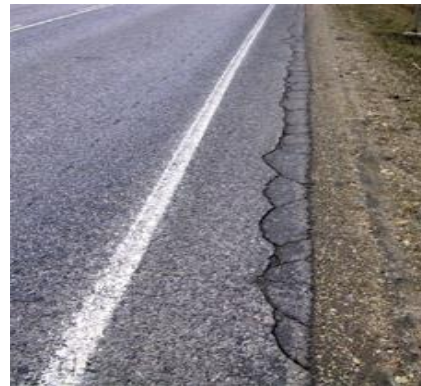
Kantsprekker Edge defect
