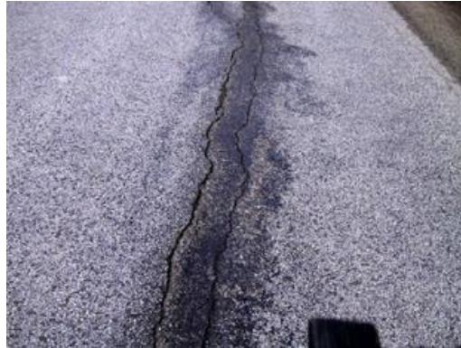
Langsgående sprekker Longitudal cracking
