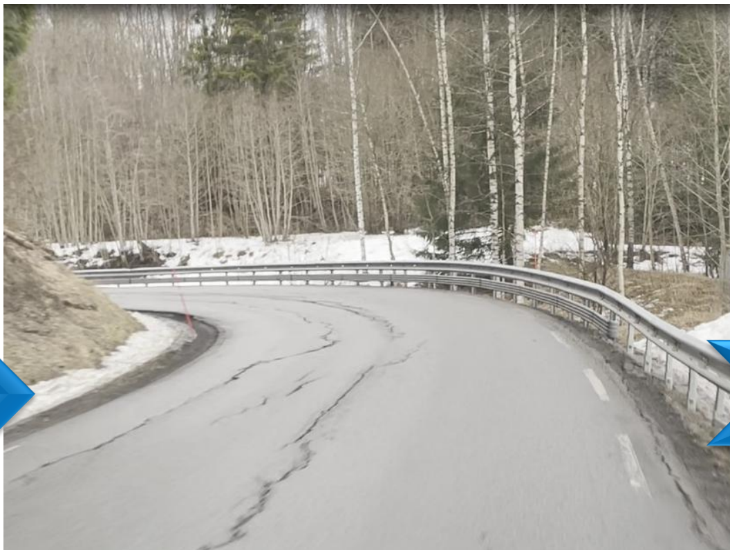
2024 – Nedbrutt veidekke før forsterkning
