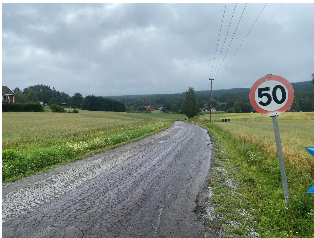
2023 – Nedbrutt veidekke før restaurering
