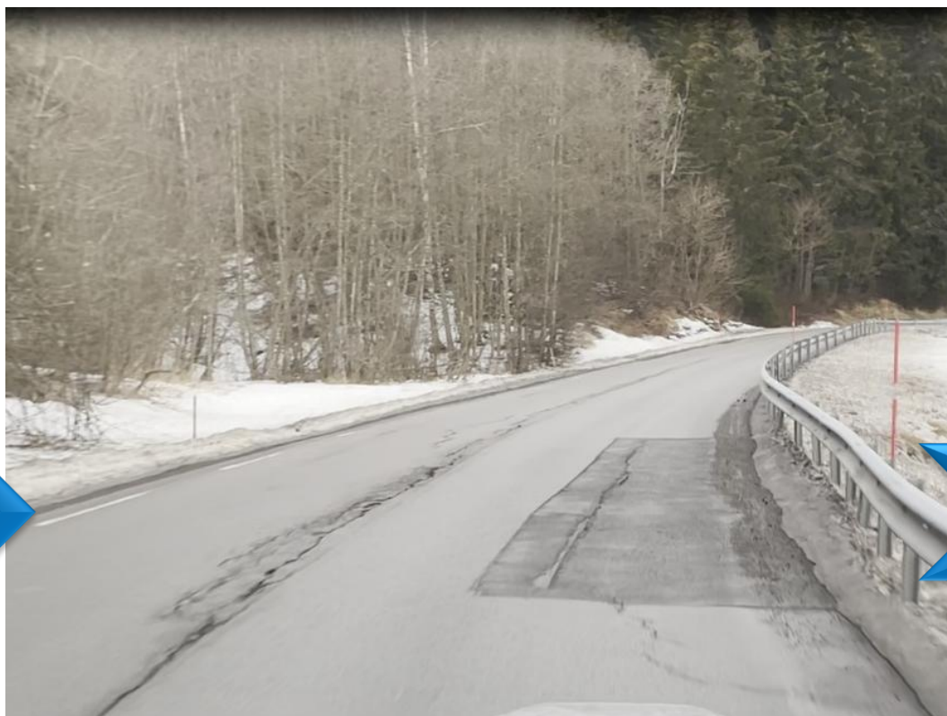
2024 – Nedbrutt veidekke før forsterkning
