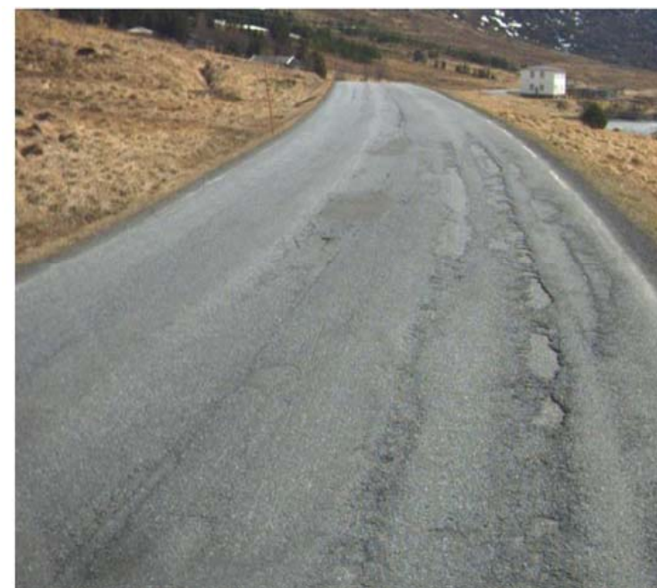
DEKKESKADER PÅ E10 (FOTO: STATENS VEGVESEN)
